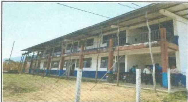
Foto1: Se observa que el edificio del centro educativo presenta un notable deterioro en la pintura, con áreas desgastadas, decoloradas y desprendidas.
