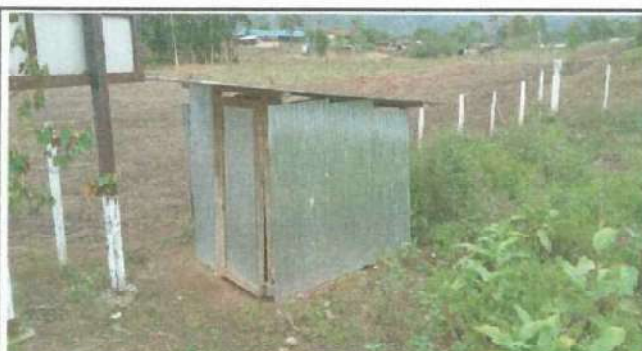
Foto 4: Se observa que el baño del centro educativo no cuenta con las condiciones necesarias para su uso, presentando deficiencias en su infraestructura, saneamiento e higiene.
